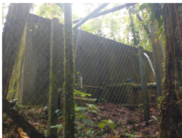
Figura 7.14 – Reservatório (São Roque)
