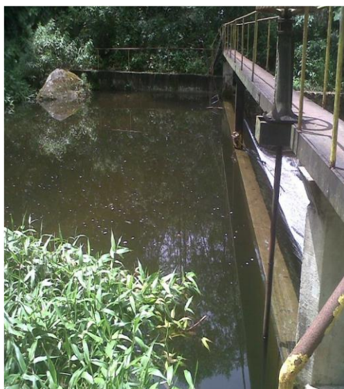
Figura 7.32 – Captação Pedra Branca Fonte: Apresentação Águas de Paraty, 2020
