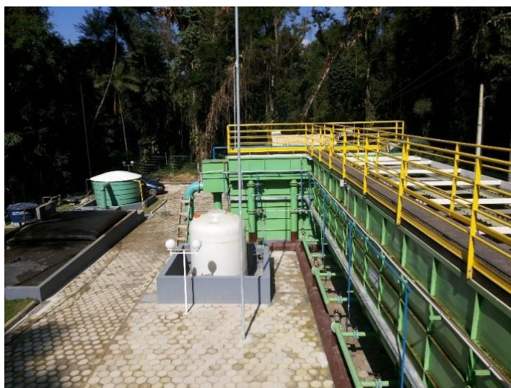
Figura 7.40 – ETA Pedra Branca Fonte: Águas de Paraty, 2021
