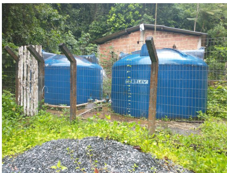
Figura 7.10 – Reservatórios (São Gonçalo)
