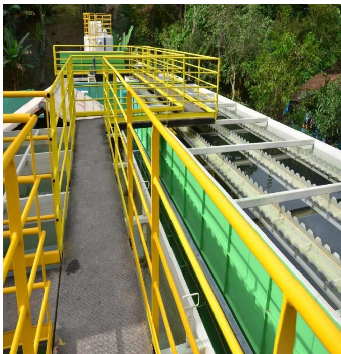
Figura 7.42 – ETA Corisquinho Fonte: Águas de Paraty, 2021
