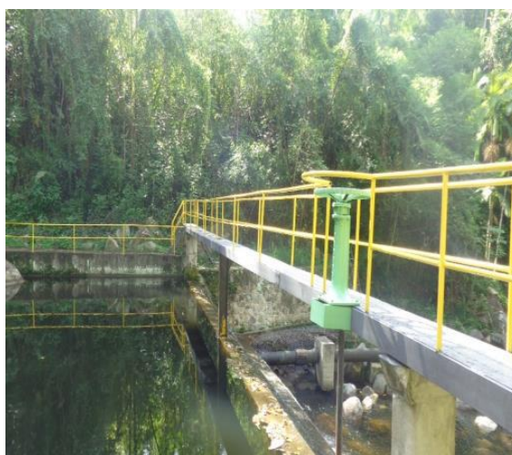
Figura 7.36 – Captação Pedra Branca Fonte: Águas de Paraty, 2021
